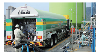
ローリー車から天然ガス を受け入れる様子
